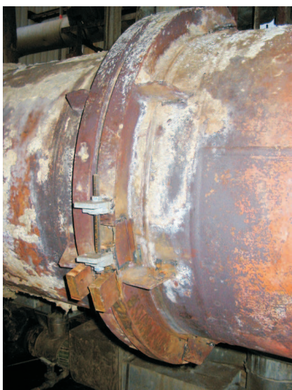
Compensator in warmtewisselaar lekt
