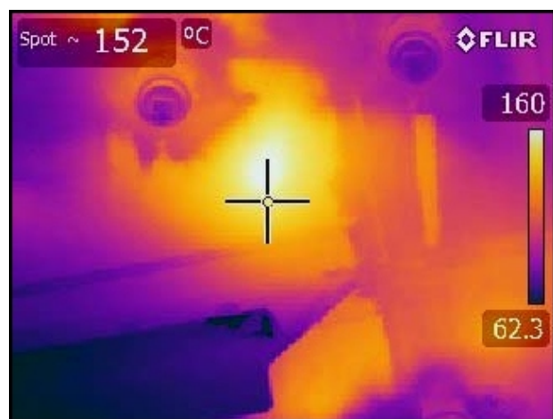
Temperatuur duct voor reparatie 160^{\circ}\text{C}
